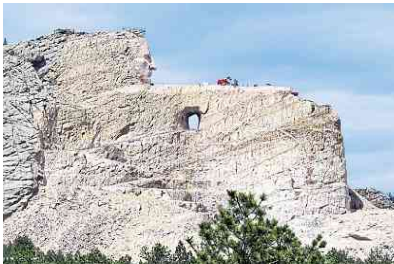
Seit 1948 eine Großbaustelle: Bis das Crazy Horse Memorial vollendet ist, werden noch Jahrzehnte vergehen. Der Kopf ist bereits sichtbar.
