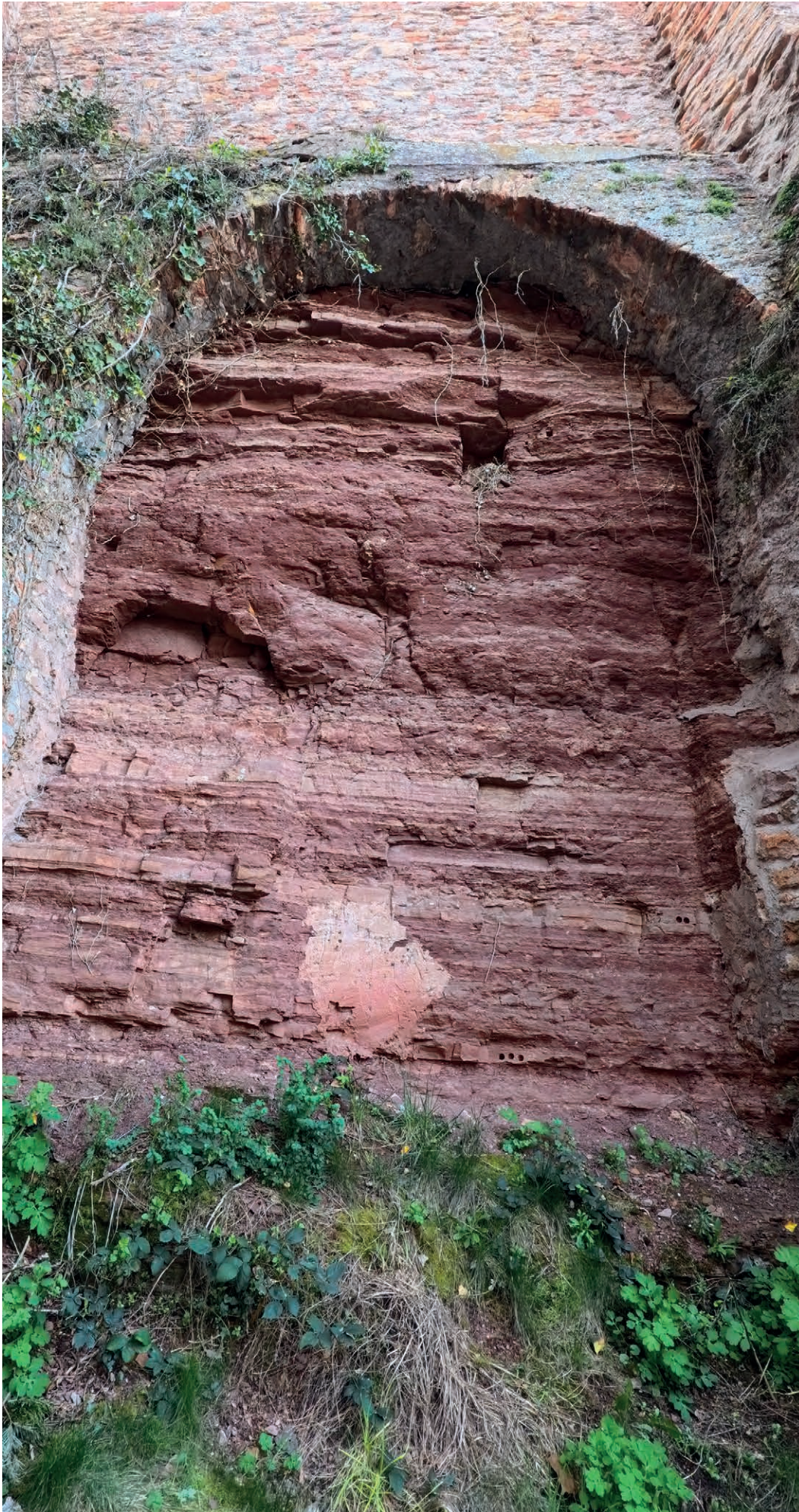
Die Stützmauer an der Hangseite der Klappergasse besteht aus geflickten Abschnitten.
