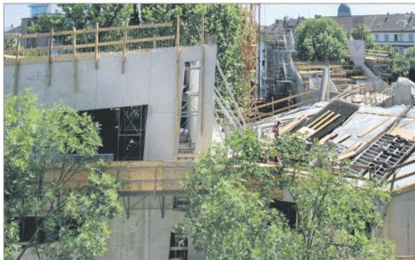
Die Synagoge an der Hindenburgstraße nimmt Gestalt an. Fenster passen sich in die spätere Verkleidung ein. ■ Foto: Bernd Eßling
