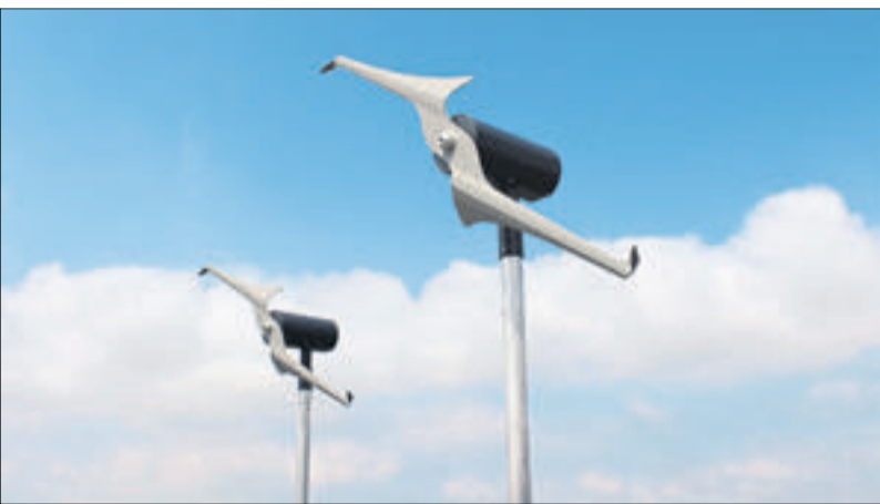
Mikrowindkraft: Kleine Windräder, auf den Dächern installiert, ergänzen die Solaranlage, wenn diese bei schlechtem Wetter nicht genügend Energie produziert.
